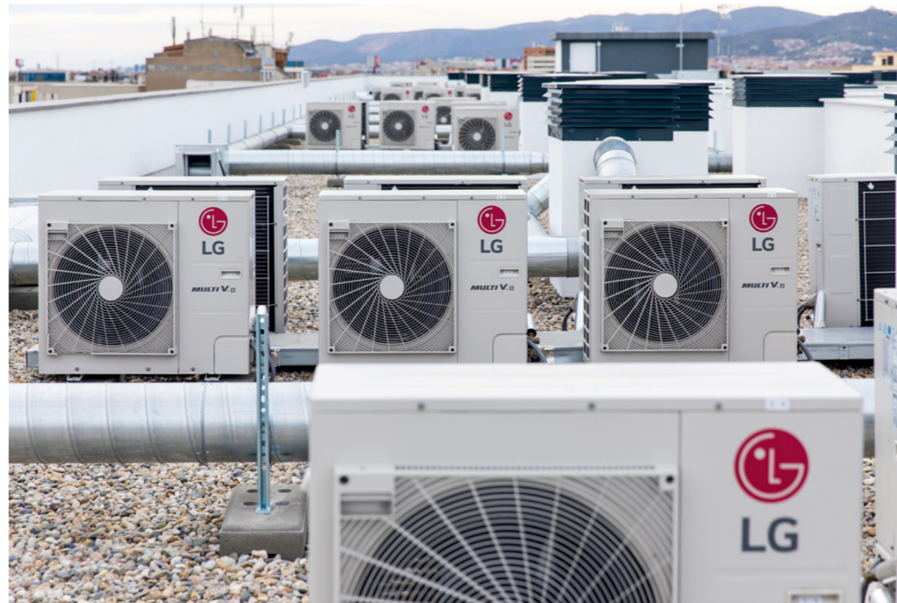
Imágenes de las 200 viviendas con aerotermia híbrida realizadas en Hospitalet, Barcelona
